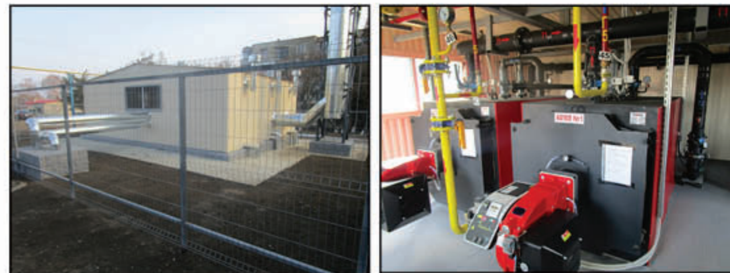
Рис.1. -Блочно-модульная котельная в г. Первомайске с котлами «КОЛВИ»
